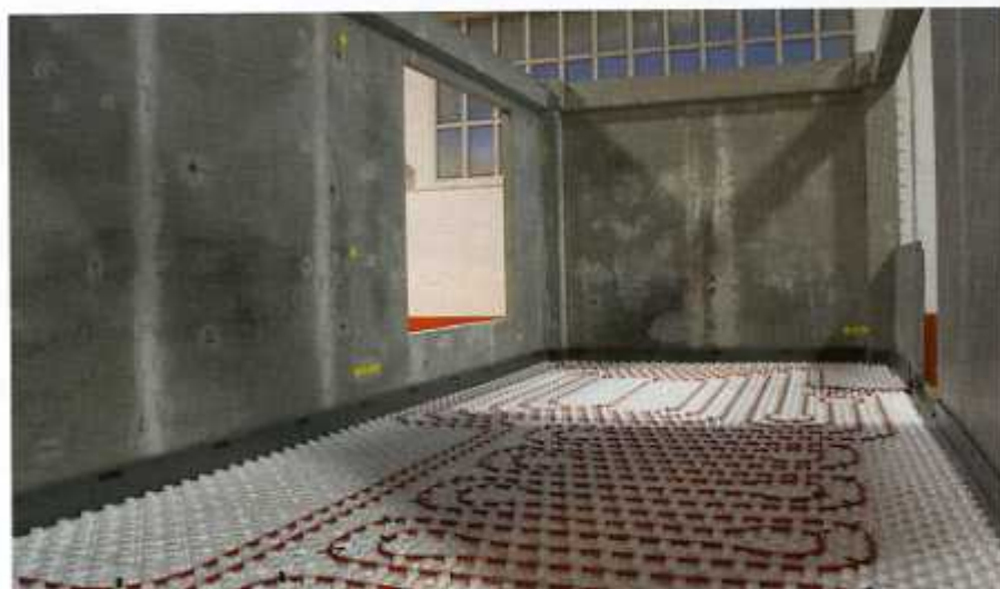
Módulo con el sistema de calefacción bajo el suelo antes de colar la capa de mortero
